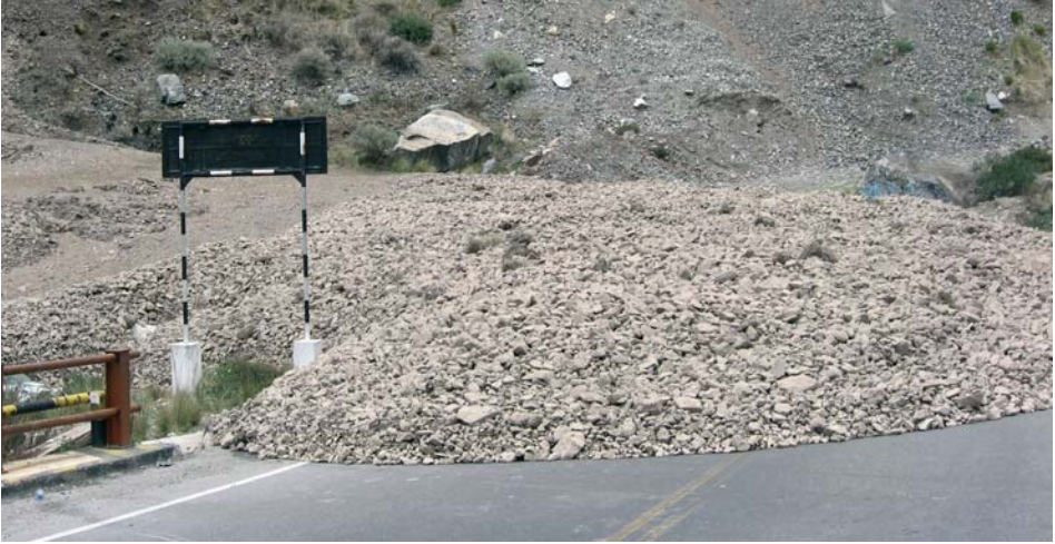
Derrumbamientos en carreteras
