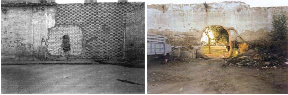
Fig. 3 y 4. Muro exterior en Los Perdigos. 1996. (Inventario Cualificado de los núcleos chabolistas en Andalucía).
