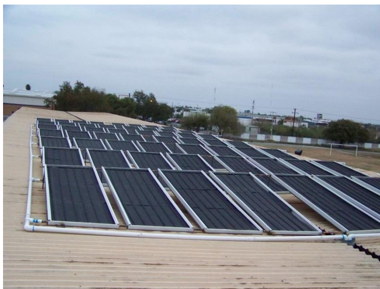
Figura 13.4 Colector solar formado por 60 paneles
