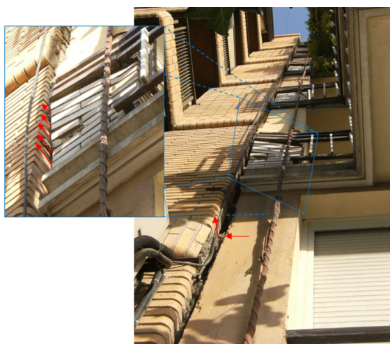
Figura 2. Detalles del desplome del edificio y del contacto entre las medianeras, con desajuste de la medianera por interacción entre edificios.
