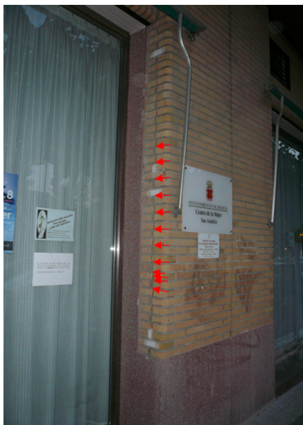
Figura 4. Fisuración vertical del paño de revestimiento de ladrillo caravista debido a una compresión excesiva.
