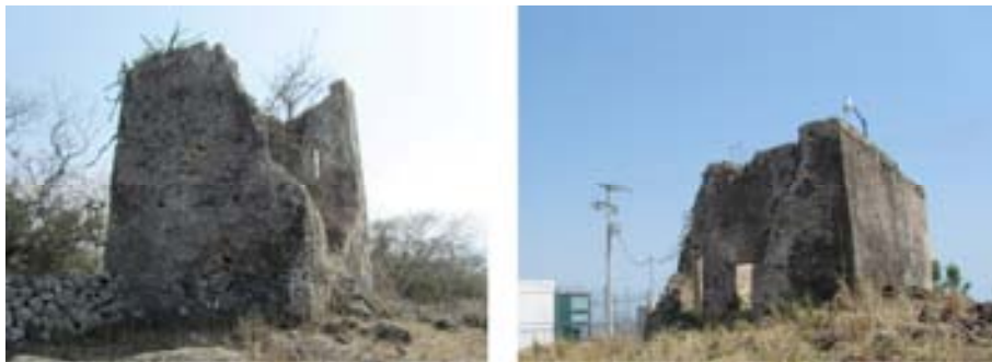
Fig. 5. En estas imágenes es posible apreciar el estado actual de los telefres de Corral Falso (izquierda) y Cerro Gordo (derecha). Fotos: Sergio Vargas, 2011.
