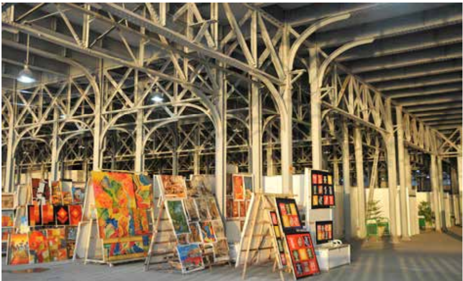
Fig. 1: Almacenes San José: valioso exponente de la arquitectura industrial, vinculado a las actividades portuarias y portador de una atractiva estructura de hierro. Su reciente cambio funcional, ahora como centro de exposición y venta de artesanía y obras de artes plásticas, permitieron el realojamiento ideal de dichas funciones así como el disfrute de su propia espacialidad y del paisaje portuario al que se asoma. (Foto: Jorge García, 2012)
