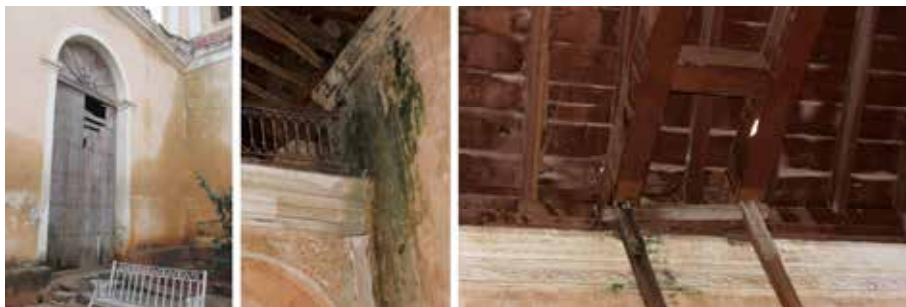
Fig. 7 – Principales afectaciones por humedades y estructurales. [Foto MSc. Arq. Reynaldo Mendoza Valdivia, año 2014]
