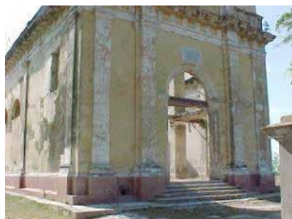
Figura 12 – Vista general del estado deplorable de la Ermita de Monserrat antes de su intervención. Fuente: Archivo del autor.
