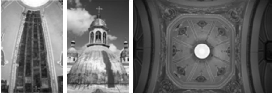
Interno ed esterno dello spicchio lesionato e della cupola
