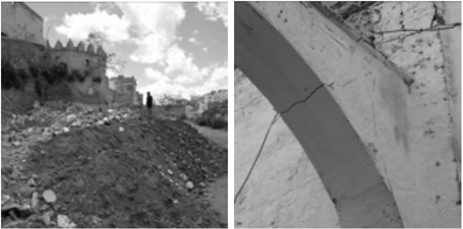
Escombrera en el aparcamiento paralelo a la muralla de la Medina dentro del recinto del Cementerio y fisuras provocadas por asentamientos en los edificios de la Medina viéndose afectadas manzanas enteras
