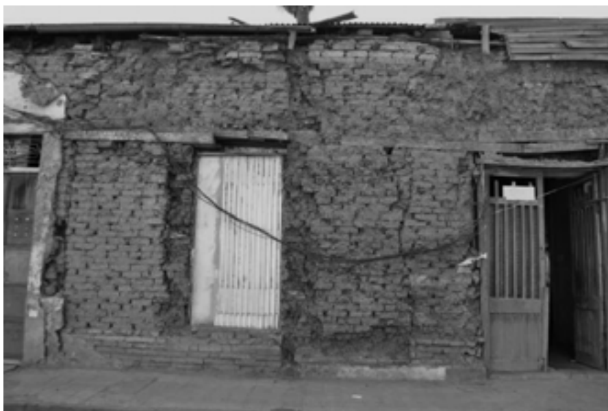
Fig.12 – Abitazione ad un unico piano interamente costruita in muratura d'adobe. Come conseguenza del terremoto del 2010, la casa perse tutti i suoi intonaci e la muratura rimase a vista.
