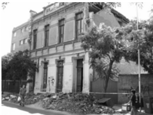
Fig.14. Palazzo che ha subito svuotamenti dei muri divisorii longitudinali, verso i terreni adiacenti abbandonati.
