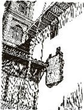
Vano tapiado de la ventana original que estaba junto a la Torre. Obsérvese que el alero del cuato de rebrujos, que fue demolido, se proyecta sobre la ventana en forma inconveniente.
