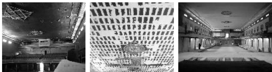
Estado del cielo raso en 2005, evolución de obra 2007 y estado de obras en 2010. Fuente: Archivo equipo de restauración y grupo de investigación Proyecto y Patrimonio
