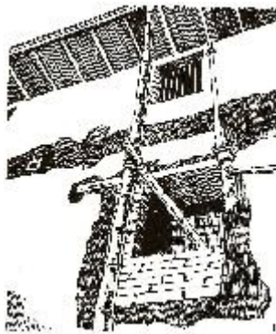
Otro de los vanos encontrados. Este corresponde al de la ventana junto a la capilla de “San Juan de Letrán” y que ilumina la nave de la iglesia. Puede apreciarse el doble muro con que había sido tapiado.
