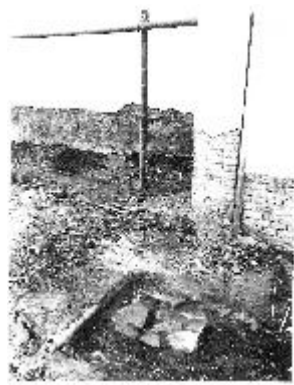
Iniciación del antiguo cimiento correspondiente a la Capilla de "San Juan de Letrán"
