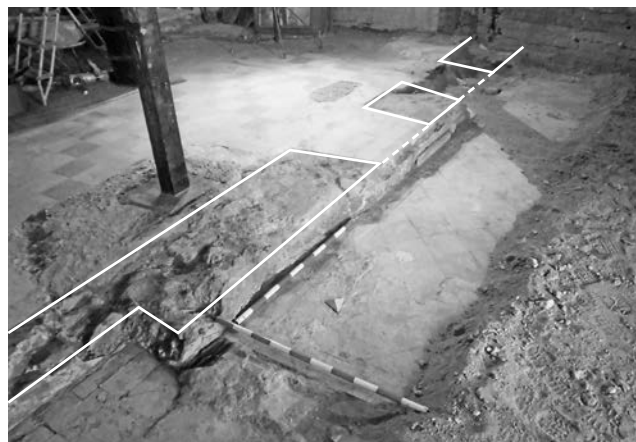
Figura 16. Vista de la cimentación del muro central de carga con los distintos huecos.
