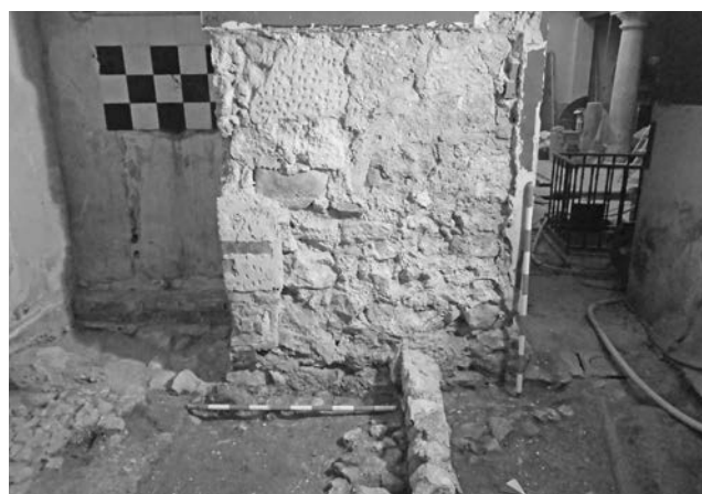
Figura 37. Cata muraria realizada en la cara trasera del muro que delimita los dos patios.
