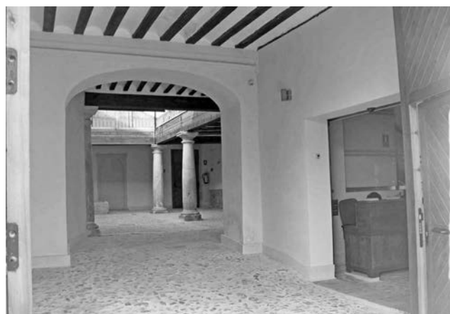
Figura 16. Vista del zaguán de entrada a la Casa de la Tercia tras la rehabilitación (Fotografía: R. Muñoz y F. Jaro).
