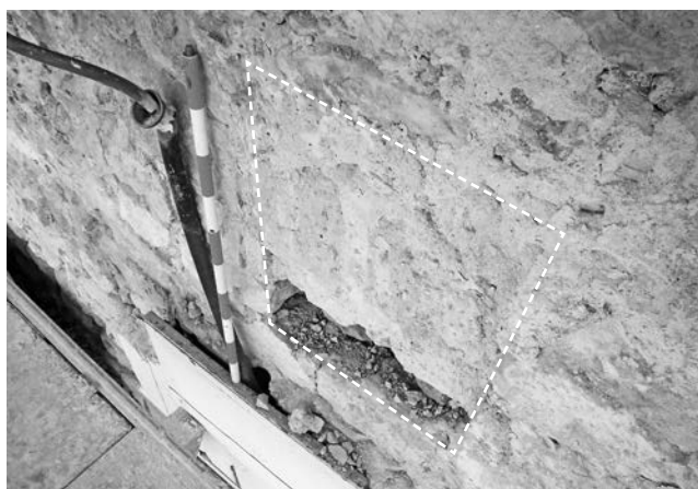
Figura 6. Ventanuco cegado de una de las celdas de la planta baja en la fachada principal.
