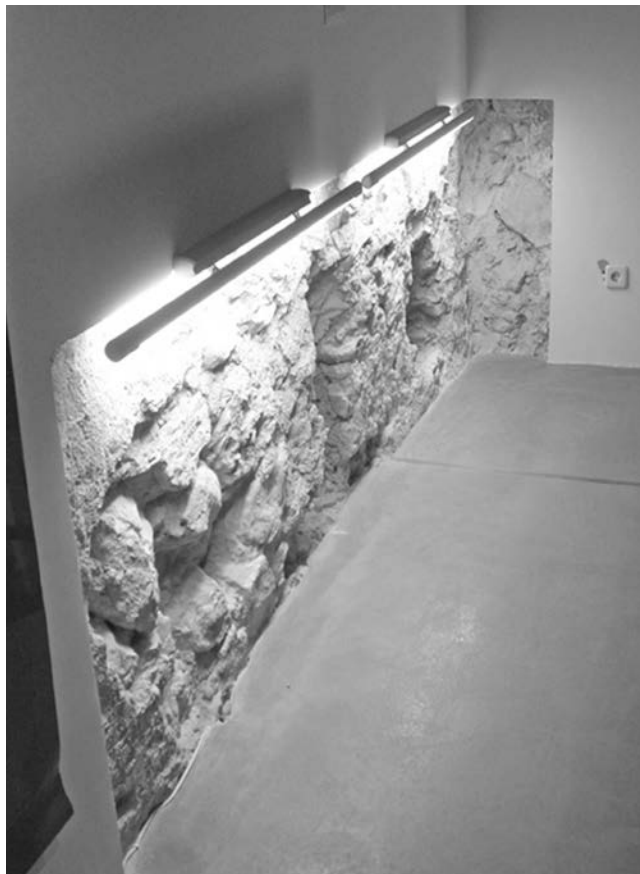
Figura 4. Vista de los mechinales de los forjados originales destacados en los acabados interiores de los muros.
