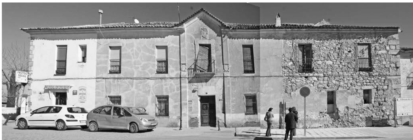
Figura 6. Estado inicial de la fachada principal de la Casa de la Tercia (Fotografía: A. Aldecoa).
