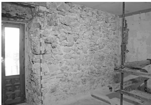
Figura 9. Interior del muro de la fachada en la primera planta a la derecha de la puerta del balcón.
