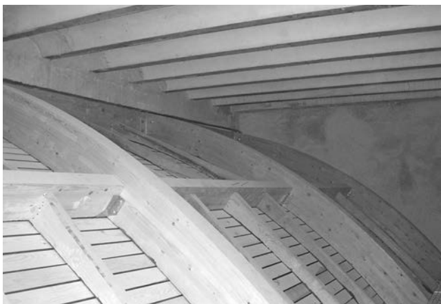
Figura 6. Vista del trasdós de la bóveda de madera que reproduce la original en la planta tercera de la Torre del Homenaje.
