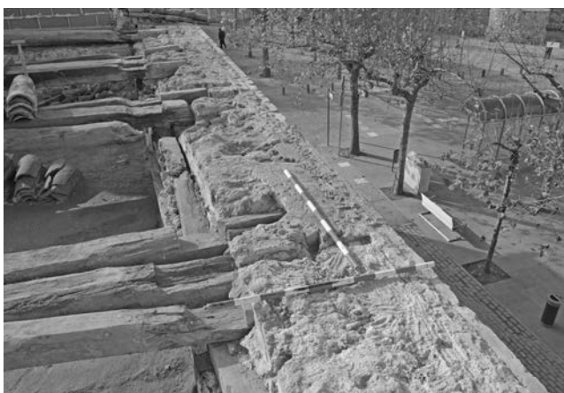
Figura 21. Vista del sistema de apoyo de los tirantes y sus refuerzos sobre la cima del muro de carga principal.
