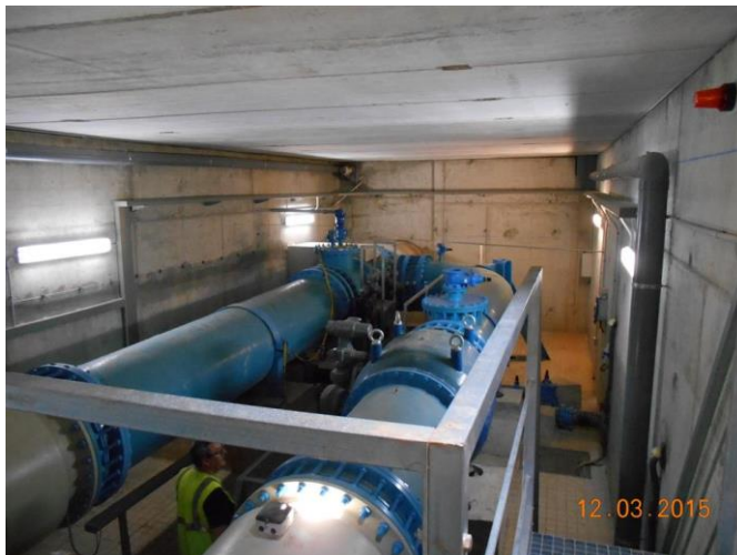
Figura 40. Vista de estación automatizada en by-pass. Fuente: elaboración propia, 2015
