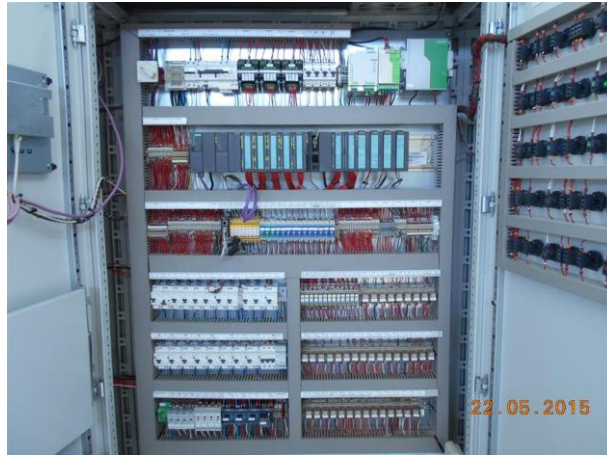
Figura 41. Cuadro eléctrico de control de una estación remota. Fuente: elaboración propia, 2015
