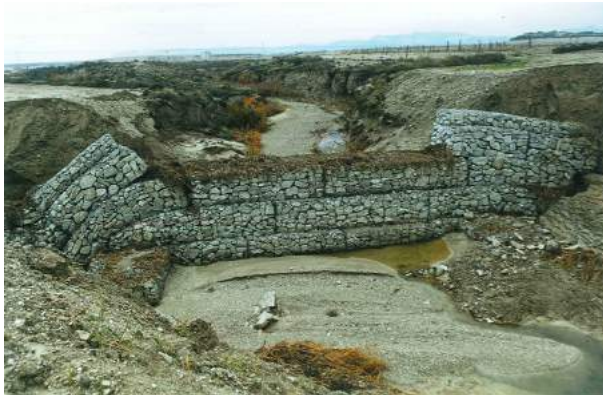
Figura 11.20: Ruina de un dique de gaviones a causa de la tubificación lateral: el agua, al ser forzada a alcanzar un gradiente hidráulico demasiado elevado, se infiltró en los márgenes descalzando la estructura (Foto: I. Pérez-Soba).
