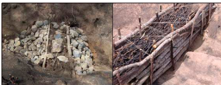
Figura 12.9: Dique mixto de mampostería y biomasa (izquierda) y detalle de la matriz interior rellena de ramas procedentes del desbroce de la vegetación afectada por el fuego (derecha).
