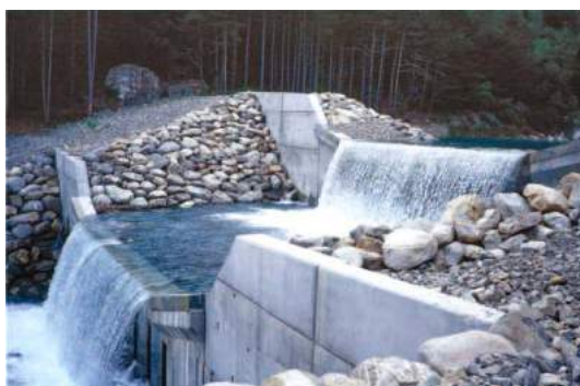
Figura 11.24: Dique de hormigón armado con cuenco de sedimentación previa, construido en Francia: perfil transversal (izquierda) y obra terminada (traducido de Tacnet y Richard, 2010: 167).
