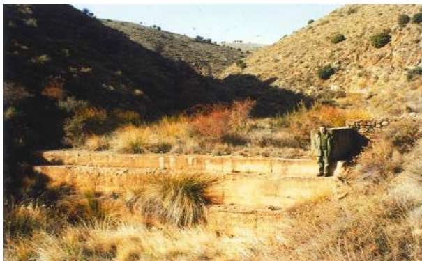
Figura 11.16: Dique de mampostería gavionada enlucida de mortero, construido en 1956 en el barranco de Bijuesca o de Carrabijuesca (Torrijo de la Cañada, Zaragoza). Está completamente colmatado de sedimentos, consolidados por vegetación espontánea.
