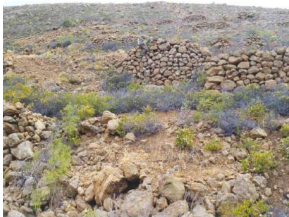
Figura 4.4: Deterioro de paredes de bancales en los altos de Arico.
