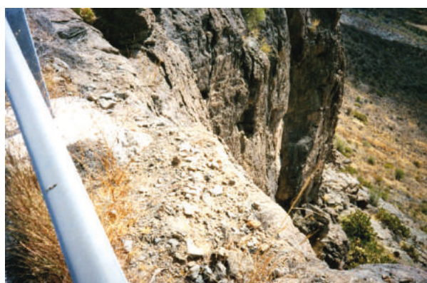
Figura 2. Detalle de la proximidad del borde de la plataforma existente a la coronación del talud vertical, dificultando las posibilidades de ampliación de la sección transversal.
