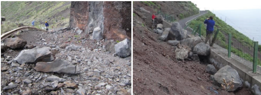
Figura 9. Detalle de las morfologías de los fragmentos de bloques desprendidos en dos puntos de la Carretera de Sabinosa, El Hierro.
