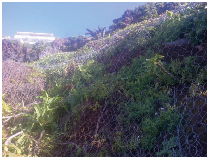
Figura 8. Vista de la malla de triple torsión reforzada con anclajes y cables.
