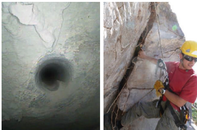
Figura 16. Izda: Perforación horizontal P-4. Grieta abierta >de 40cm a los 3,5m de profundidad. Dcha: Labores de auscultación del talud. Bloque inestable y efecto de las raíces sobre la grieta abierta.
