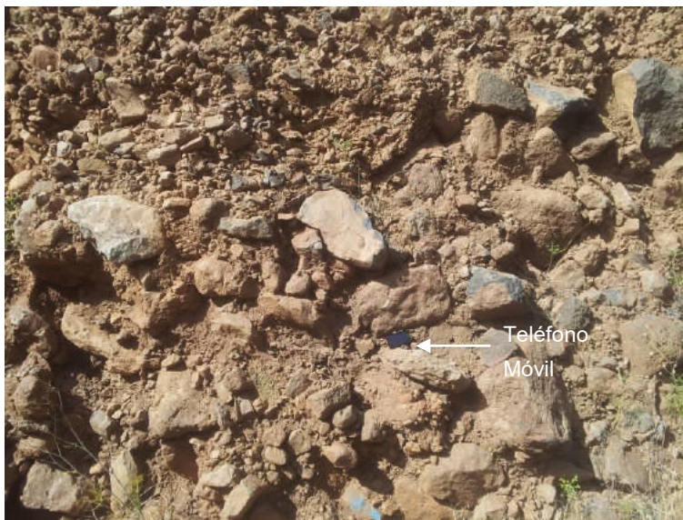
Figura 4. Talud vertical en acarreo de Barranco en La Gomera.
