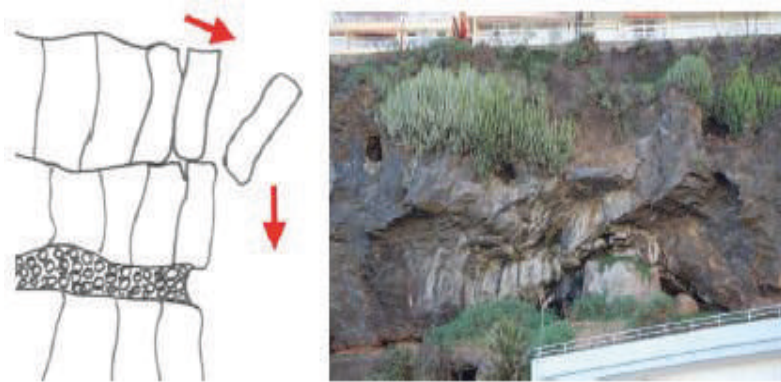
Figura 2. Inestabilidad por desprendimiento de bloques.
