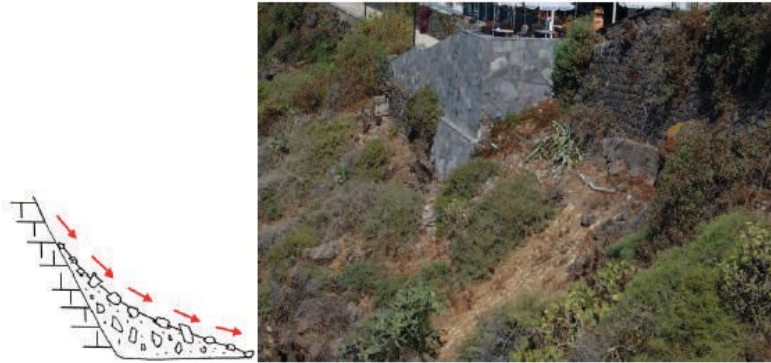
Figura 5. Inestabilidad por flujo de detritos.
