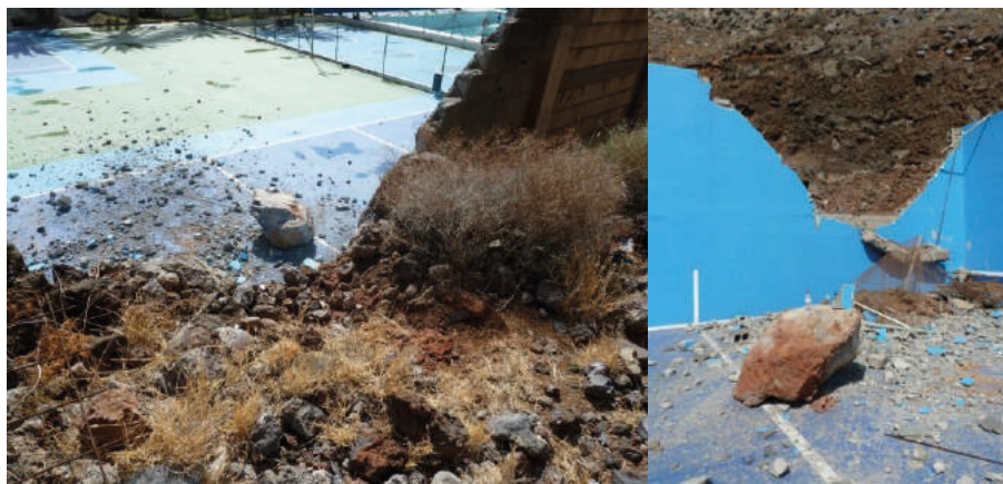
Figura 6: Daños en el muro del frontón producidos por el impacto del bloque desprendido.
