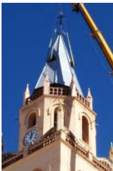
Fig. 3: Chapitel de la Torre de la Iglesia de Villafranca de los Barros (Badajoz)
