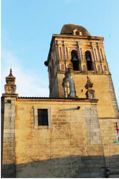
Fig. 5: Imitación de cantería, Iglesia de Santa María de la Encarnación, Jerez de los Caballeros (Badajoz)
