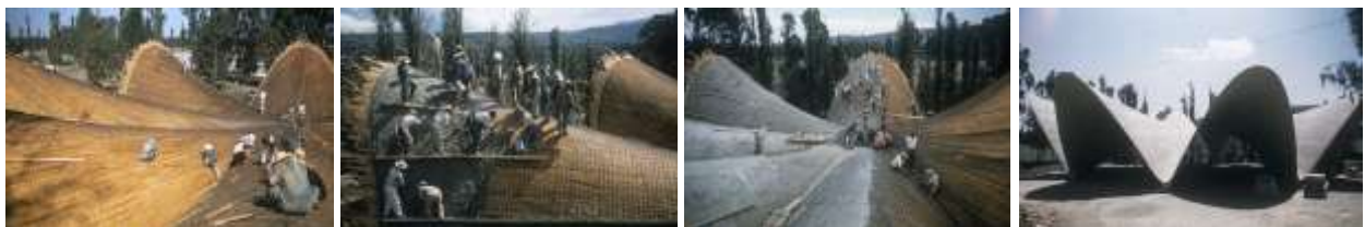
Fig. 6. Proceso constructivo del restaurante Los Manantiales, donde se aprecia el tendido del armado, el vertido del hormigón y el cascarón recién desencofrado. Fotos: Juan Guzmán, 1958 (AFMT-IIIE UNAM)
