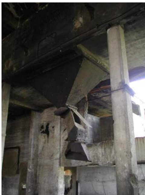
Figura 2. Instalaciones interiores. Tolva
