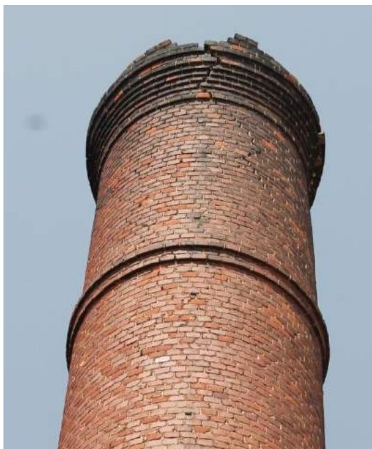
Figura 5. Fisuras en la coronación de la chimenea
