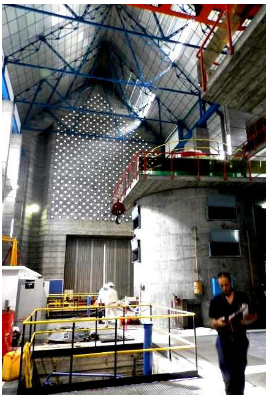
Figura 3: Central de Ip. Vista interior de la sala de máquinas.
