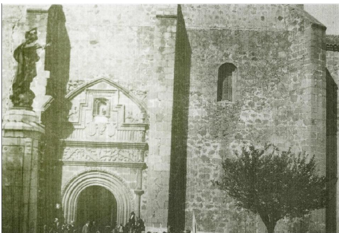
Figura 19. Fotografía realizada en 1925. Detrás de la figura del Cristo se aprecia lo que puede ser un agrietamiento vertical considerable en el muro sur.
