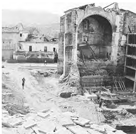
Fig. 51 Hospital de la Merced durante el proceso de demolición y movimiento de tierras. Foto Hoy.
