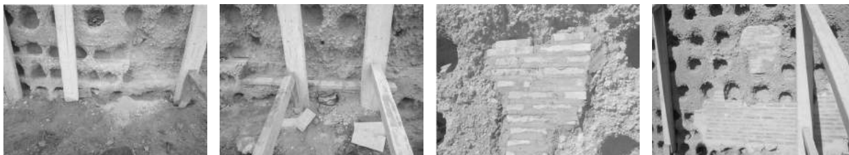
Figura 3. Procés constructiu. Consolidació del mur de tàpia amb obra de maó massís i morter de calç. Fotografies: Marilena Gracia Suñé, José Luis Sanz Botey, arxiu SPAL
