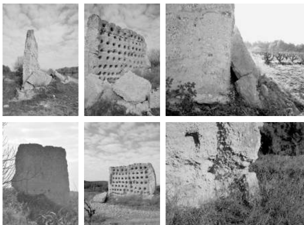
Figura 1. Diversos aspectes de l'estat inicial. Fotografies: Rosa Escala i José Luis Sanz Botey, novembre 2011. Arxiu SPAL
