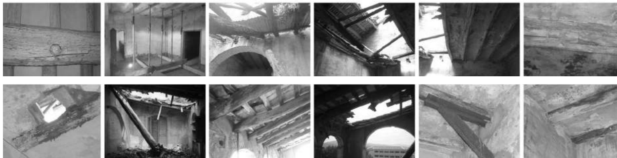
Plànol i imatges de l'estudi de les patologies dels sostres i cobertes de la planta primera
