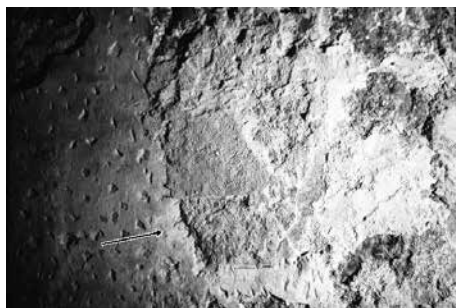
Fig. 16. Restos de ménsula de arco diafragma en muro S.
