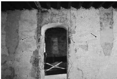
Fig. 13. Restos de arcos diafragma en muro N.
