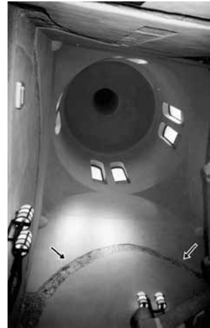
Fig. 28. Vista de la cúpula sobre tambor y pechinas de la escalera NE y restos de uno de los arcos que conformaban el remate de la escalera en la 1ª F. C. con bóveda de crucería.
