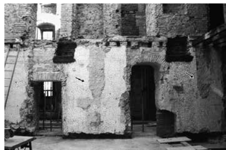
Fig. 14. Restos de arcos diafragma en muro N.
