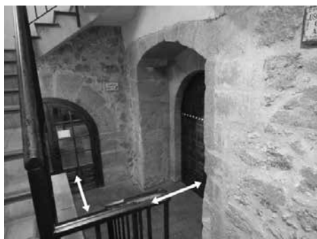
Fig. 33. Puertas de la 1ª F. C. de salida hacia el norte por la fachada principal al N. En la actualidad.
