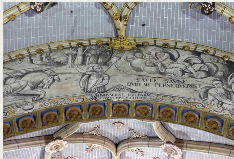
Grillada del arco de gloria (hacia la cabecera) y decoración de yeso aplicada en las nervaduras y en el intradós del arco
