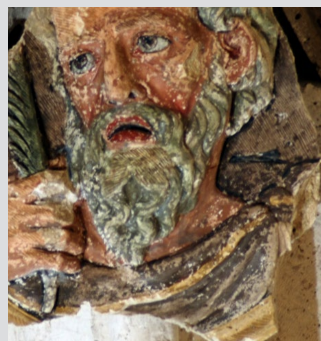
Medina de Rioseco. Convento de San Francisco Capilla de los Villasante. Anclaje metálico del medallón
