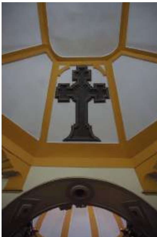
Fig. 3. Detalle de la cubierta de la ermita del Cristo del Calvario de Pinto.
