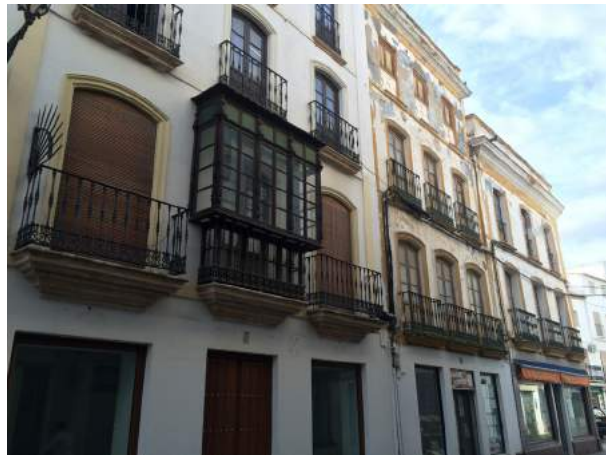
Lám. 11. La casa del número 5 de la calle Mas y Prat no recuperó los tonos de color subyacentes.
