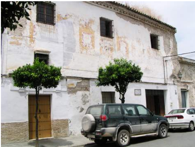
Lám. 31. Fachada del antiguo Hospital de San Pedro, San Pablo y San Juan de Dios, con restos de pinturas murales. 1 de junio de 2003. AMP.
