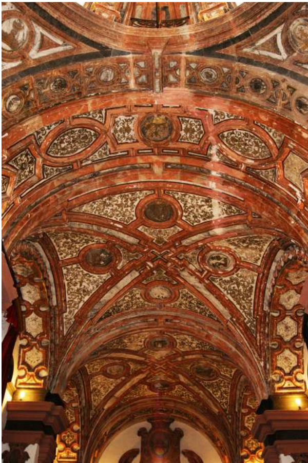
Lám. 39. Bóvedas de la nave de la Capilla de la Virgen del Rosario. Iglesia del Convento de San Pablo y Santo Domingo. (RSGA).
