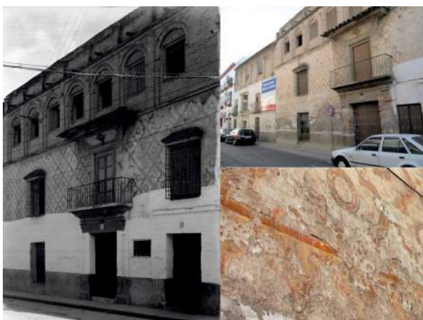
Lám. 26. Casa del Gremio de la Lana. Estados anteriores a la intervención.
