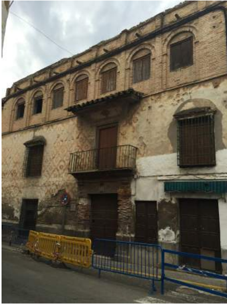
Lám. 13. Casa del Gremio de la Lana con desprendimientos en 2015. AMP.
