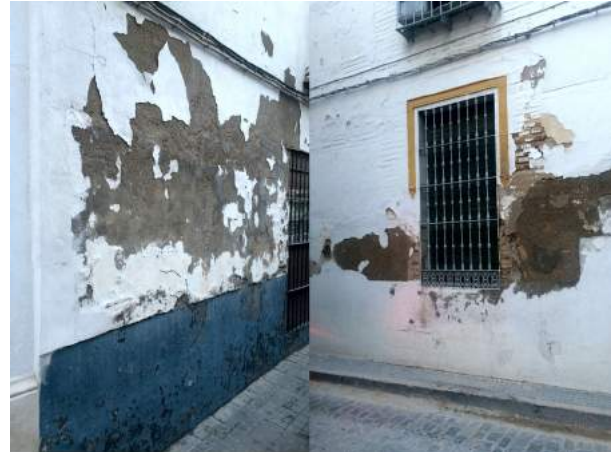
Lám. 13. Pérdida de revestimientos por humedades de capilaridad.
