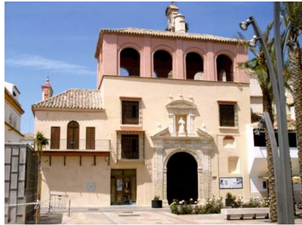
Lám. 30. Restauración de fachadas y reconstrucción de galería mirador en Iglesia de San Francisco.
