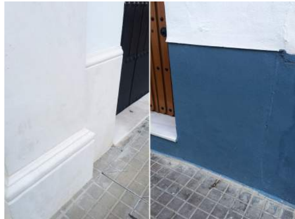
Lám. 32. Sustitución de los zócalos tradicionales pintados en color por los de piedra caliza.
