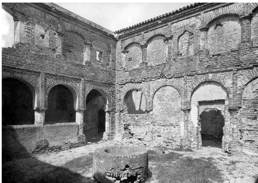
Fig. 4: Aspecto del claustro del convento de Tentudía, muy afectado por el abandono. Gestoso, como otros muchos, temía que aquella situación terminara afectando a las capillas de la cabecera de la iglesia donde se ubicaba la importante obra cerámica de procedencia sevillana.
