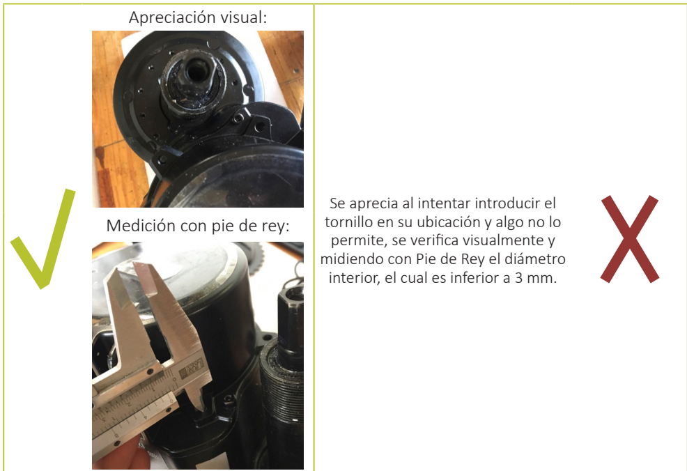
Figura 11. Exceso de pintura en orificios (Código EPO).
