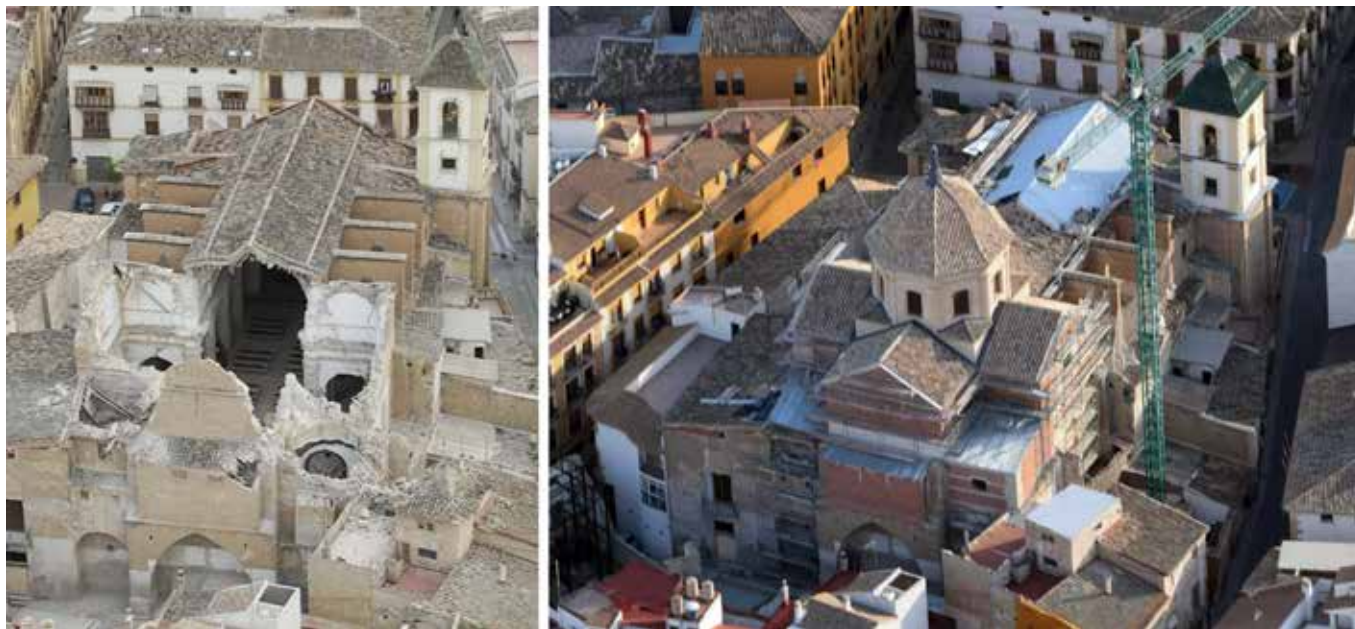
Reconstrucción de la Iglesia de Santiago, Lorca, Murcia Reconstrução da Igreja de Santiago, em Lorca, Múrcia Reconstruction of the Santiago Church in Lorca, Murcia
