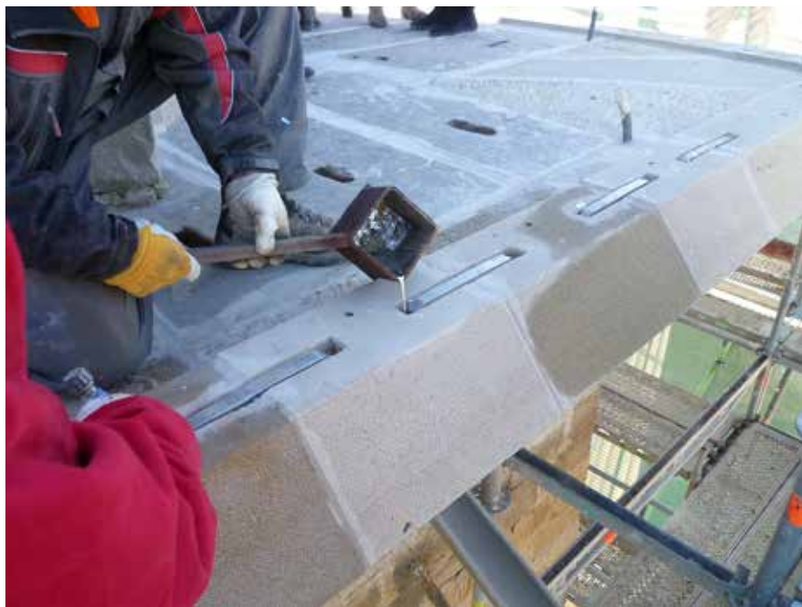
Proceso de emplomado de uniones metálicas entre sillares Processo de revestimento com chumbo de uniões metálicas entre blocos de granito Fastening ashlar using iron staples and leaded joints
