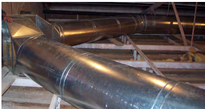
Conductos de renovación del aire de la sala alojados en el vacío de cubierta
