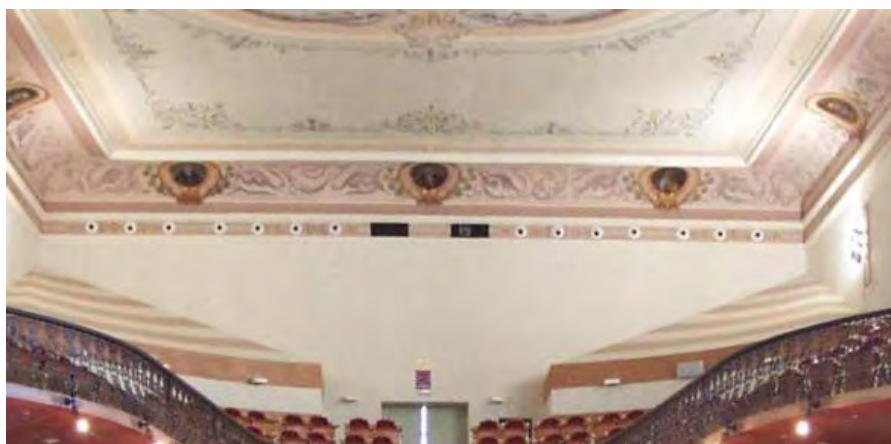
Emplazamiento de las boquillas de impulsión del aire renovado procedente del recuperador.
