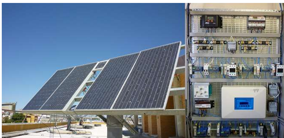
Figura 1: Sistemas Fotovoltaicos Autónomos. Armario de Conexiones Eléctricas.
