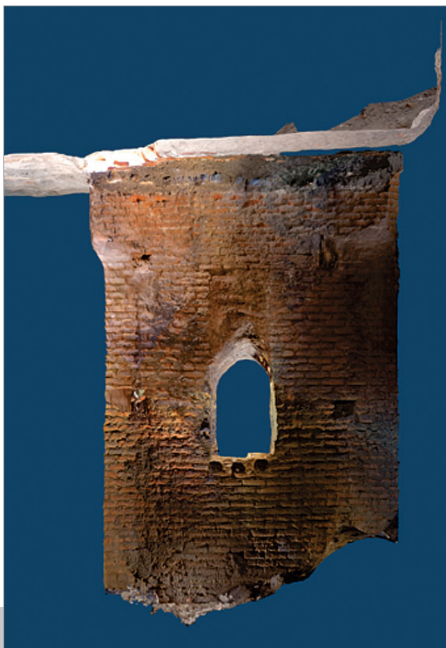
Figura 3. Sección fotogramétrica de la noria del Palacio de Villagonzalo. La zona sin textura en el centro de la imagen se corresponde con el contrafuerte de ladrillo que ataba los dos lados largos de la estructura.
