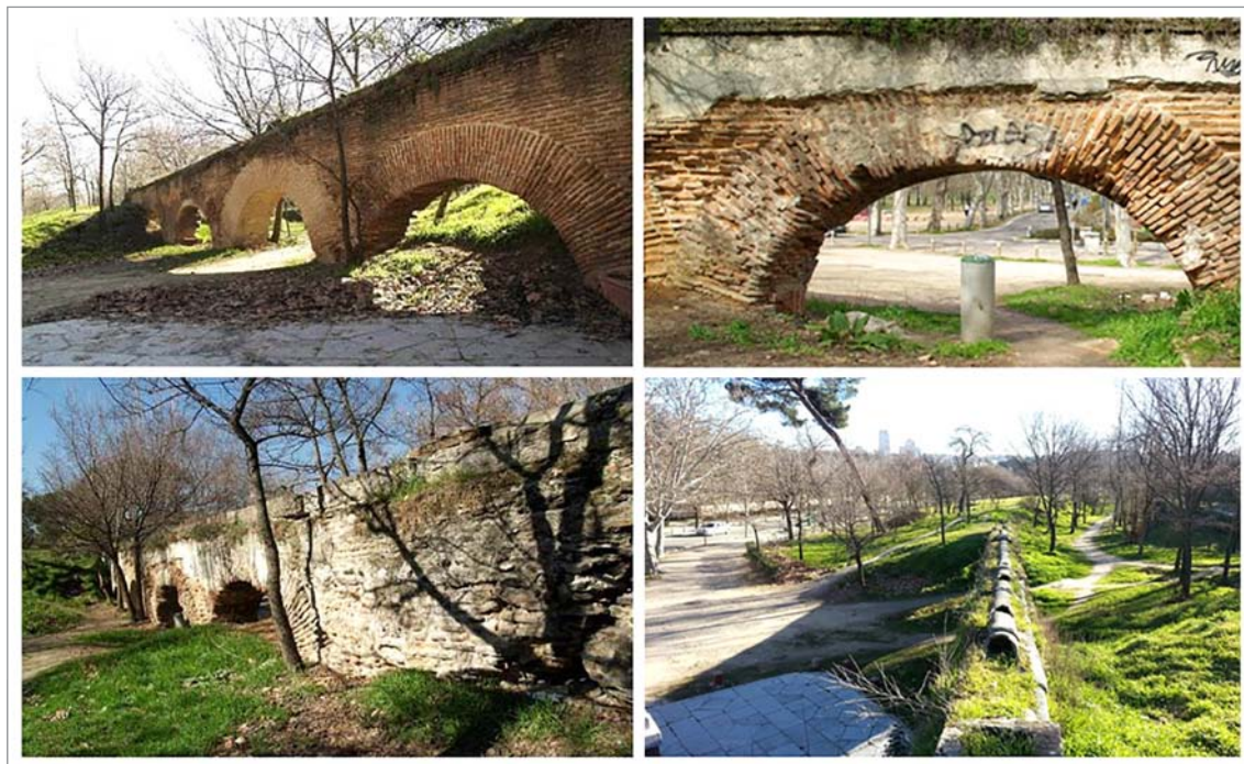
Figura 2. Estado del acueducto en 2015.
