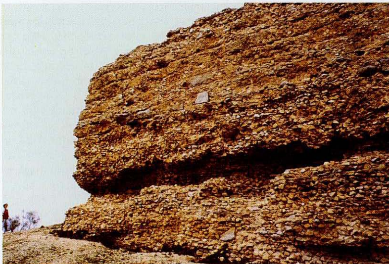
Fig. 8.9.-Muro de la presa con socavones horizontales que penetran profundamente en la capa de mampostería hormigonada.
