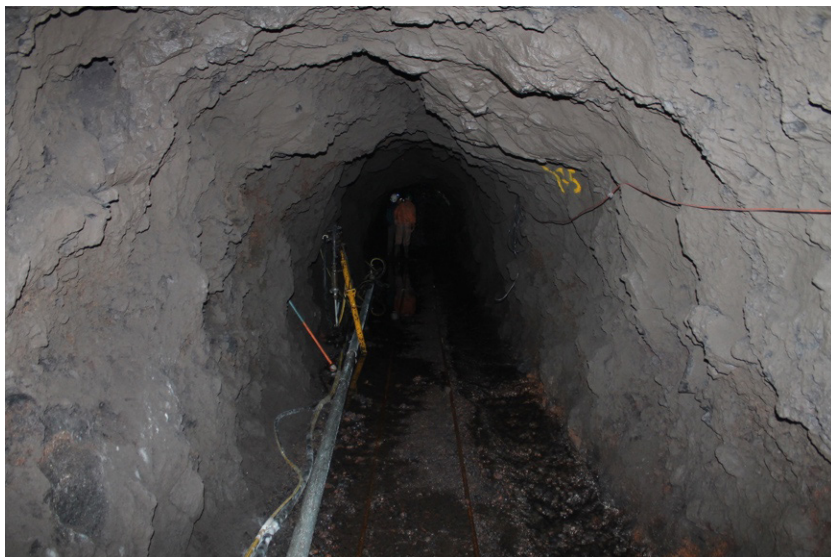
Figura 6. Galería en fase de reperfusión para aumentar los caudales. Fuente: Santamarta J.C.
