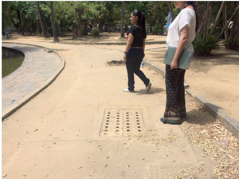
Figura 8 – Drenos e lagoa sem proteção
