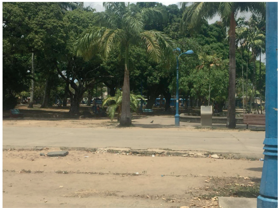
Figura 10 - Desnivelamento de piso
