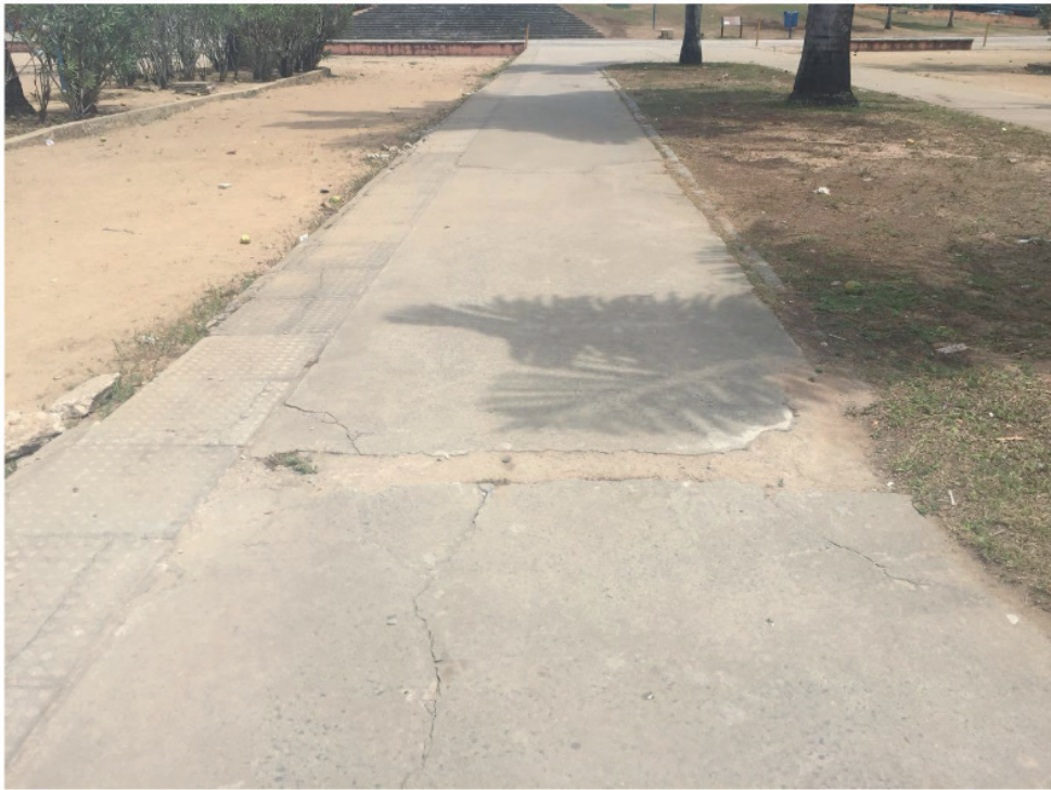
Figura 5 – Piso desnivelado, com muitos buracos
