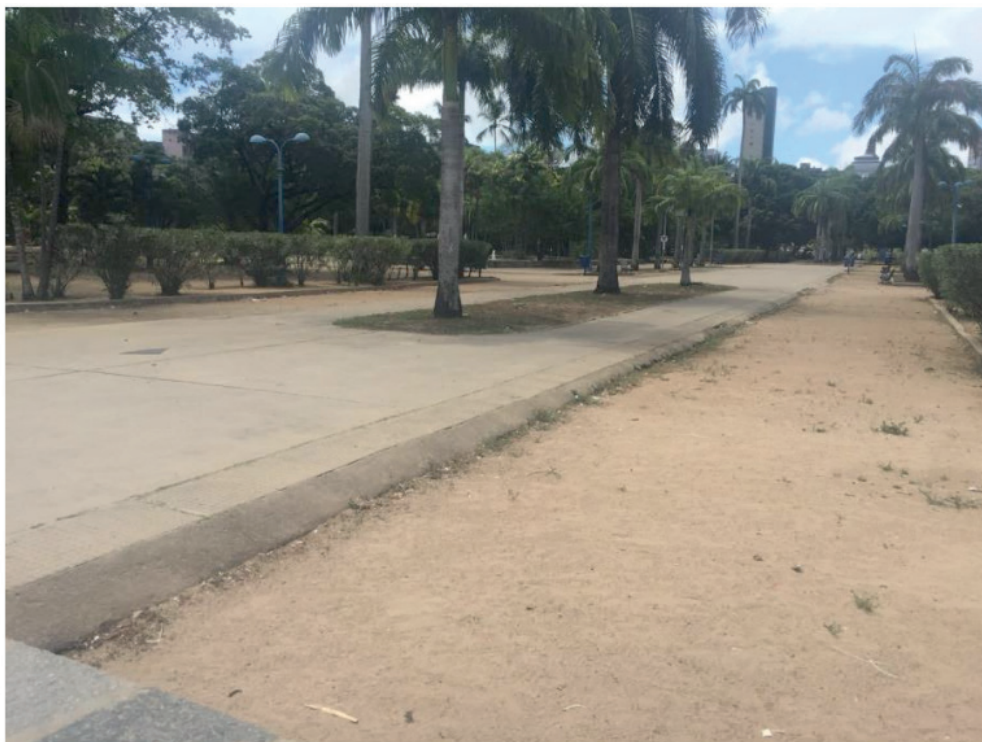
Figura 13 – Desnível acentuado no piso
