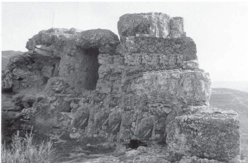
Aspillera y muros ruinosos
