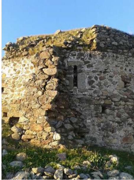
Ventana y muros en ruinas.
