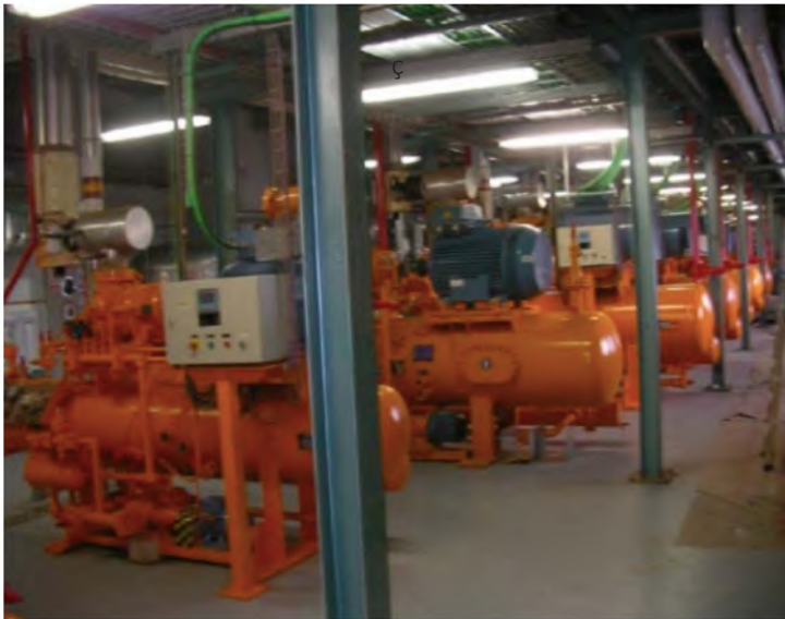
Figura 5. Vista de la sala de compresores de refrigeración industrial en estudio.
