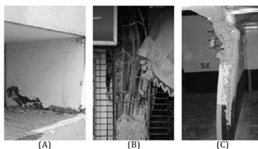
Figura 5. Fallas en muros de CR - Chile y Nueva Zelanda: (A) aplastamiento del concreto, (B) pandeo del refuerzo, (C) pandeo fuera del plano del muro [7, 9]
