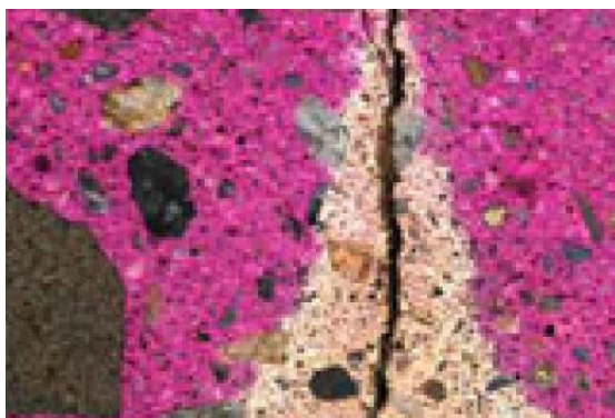
Figura 8. Ensayo de Carbonatación
