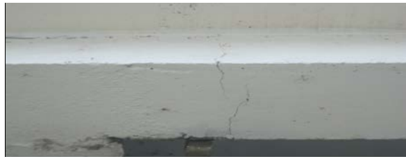
Figura 12. Fisuras leves es Vigas de Concreto
