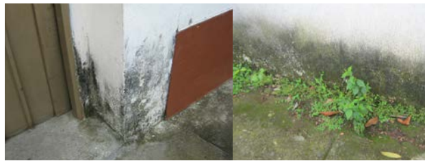
Figura 13. Humedades por capilaridad y absorción
