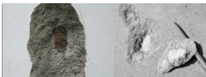
Figura 11. Erosión en muros y elementos estructurales de concreto
