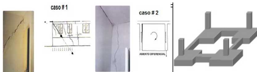
Figura 14. Grietas por asentamiento diferencial en zapatas
