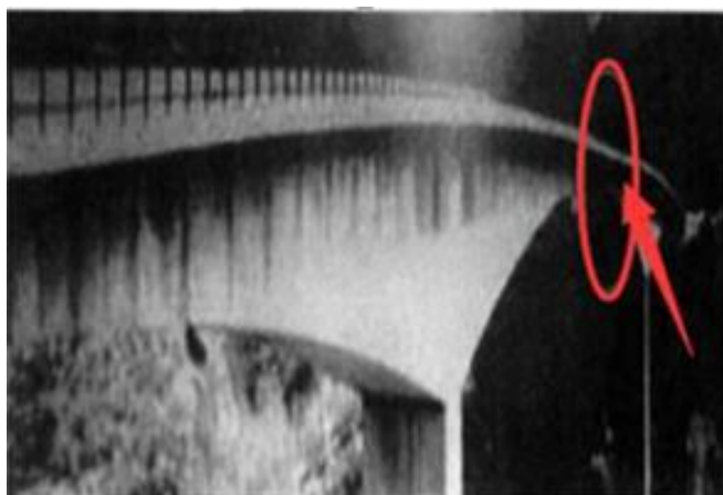
Figura 2. Efectos a largo plazo evidenciados en el puente Parrots después de 12 años [15]
