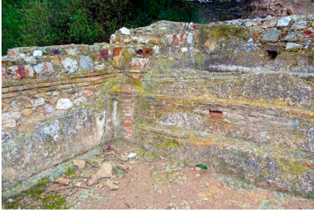
Fig.7. Detalle de las construcciones termales; obsérvese en el ángulo inferior izquierdo, la gran cantidad del revestimiento de opus signinum caído en el suelo. Esther Núñez
