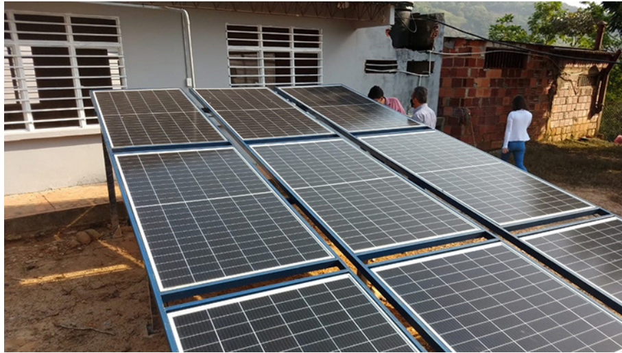
Figura 2. Sistema fotovoltaico escuela Santa Bárbara vereda San Miguel
