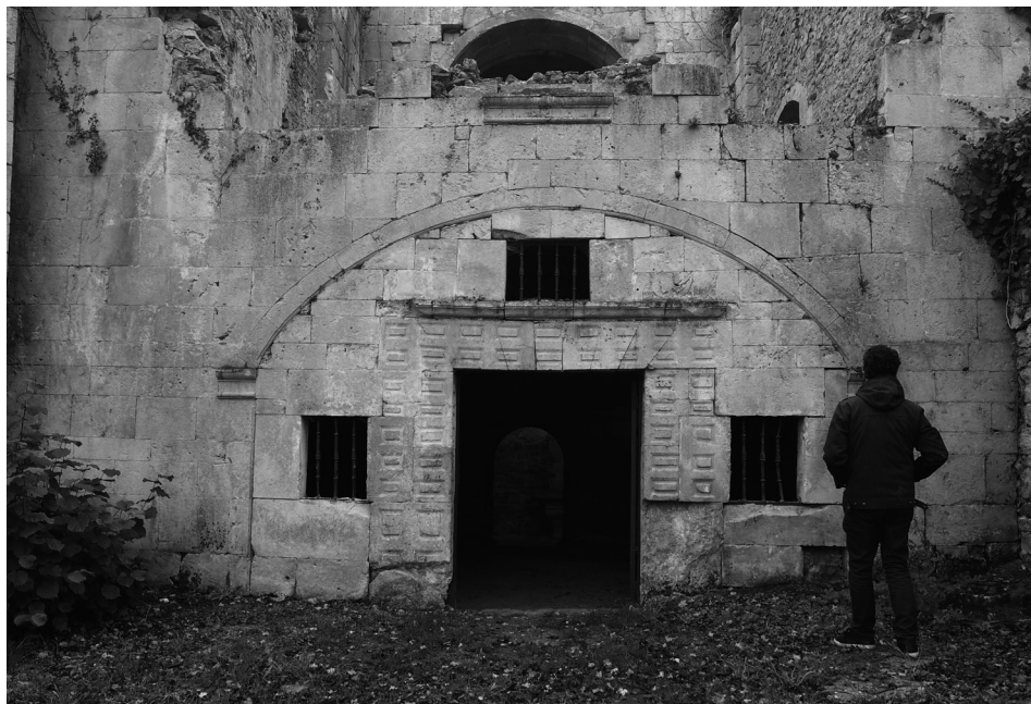
Imagen 9. Cerramiento y arco adintelado añadido bajo el arco rebajado de la portería norte.
