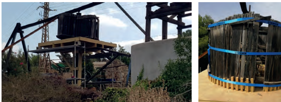
Figuras 5 y 6. Imágenes de los trabajos de apeo provisional del malacate realizados en agosto de 2021. Fotografías: Sonia Hernández Gómez.
