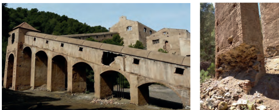
Figura 4. Lavadero El Lirio, conjunto minero de Ponce. Es urgente la intervención en los pilares del transporte para evitar su colapso.
