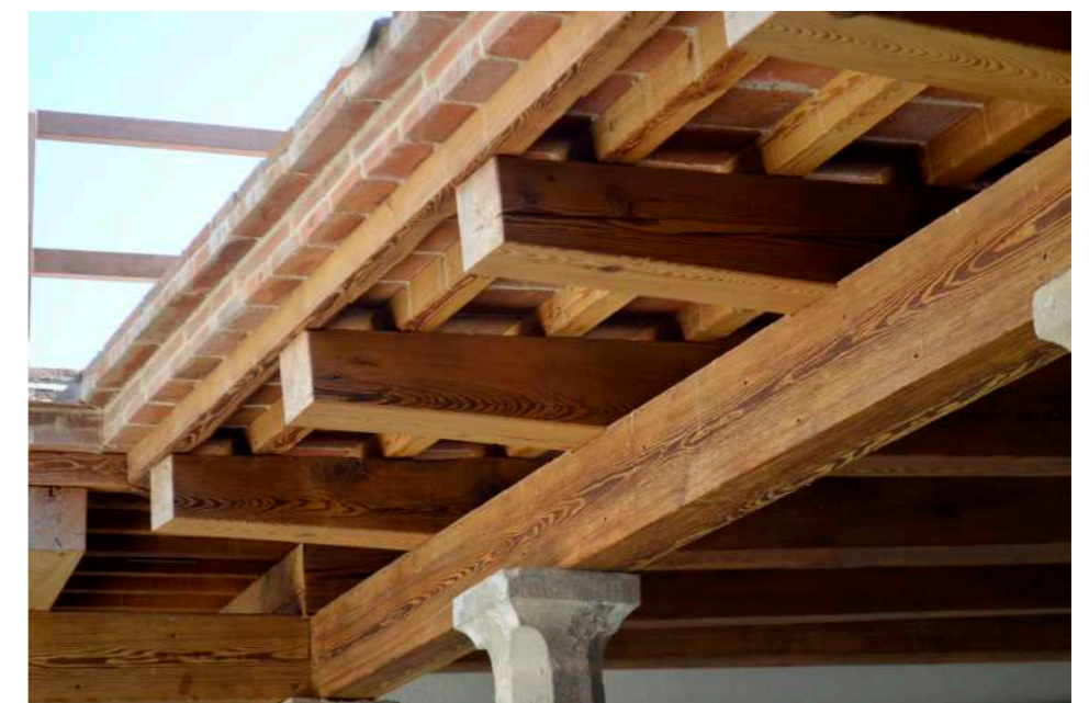
Detalles de distintos encuentros de las vigas que conforman la estructura del claustro
