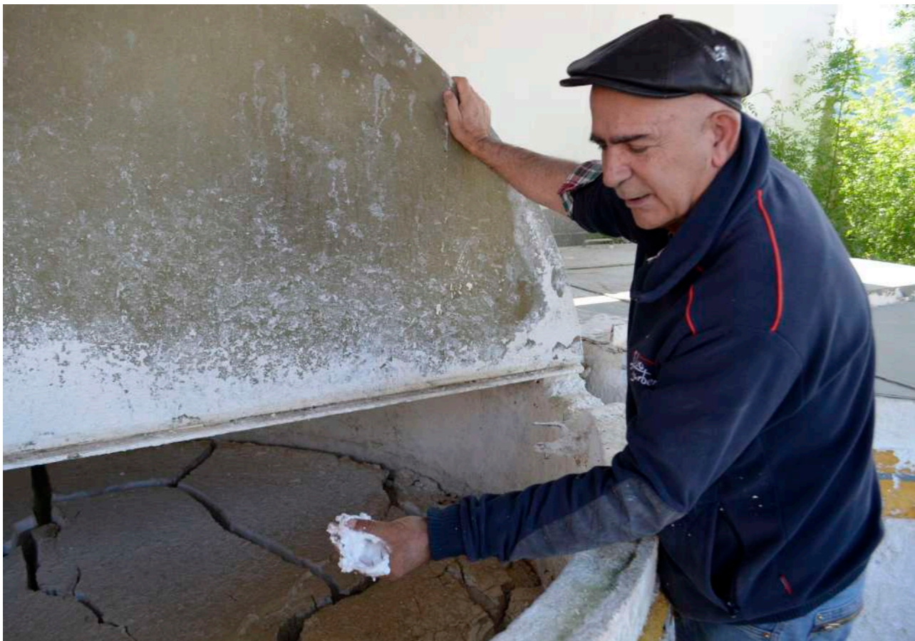
Depósitos de cal en Burgohondo, Ávila
