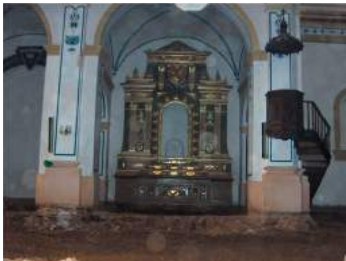
Fig. 9. Cabecera de la iglesia. Vistas de una de las capillas laterales en la nave lateral occidental. Se aprecian los tirantes de cimentación que unen ambos pilares una vez retirado el pavimento.
