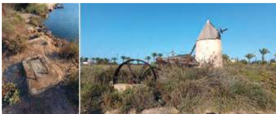
Figuras 15 (izqda.): Detalle de los restos del edificio destruido, donde se hallaba el motor. Figuras 16 (dcha.): Conjunto del sistema de poleas y ruedas dentadas que accionaban el tímpano en la instalación aneja al molino BIC nº167 y al fondo el molino con los restos muy deteriorados del suyo. Fuente: El autor.
