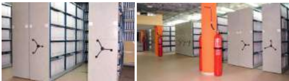
Armarios móviles sobre raíles y sistema contra incendios del AMSJ en la actualidad.
