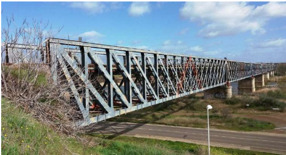
Fig. 5: Vista de del puente metálico sobre el río Guadiana, en Mérida (1882). Archivo autor
