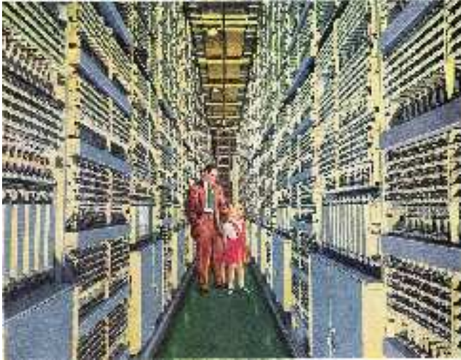
Figura 5.9: Anuncio de Western Electric de 1950, un padre muestra orgulloso a su hija el interior de una central electromecánica de barras cruzadas. La disposición de los equipos era la misma que para las centrales tipo Rotary o Strowger , pero el volumen ocupado por cada línea de abonado resultaba menor. También se redujo el coste de mantenimiento. Obsérvese la completa falta de luz natural.
