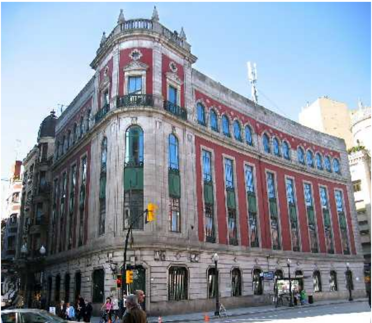
Figura 4.94: Central telefónica, Gijón, plaza del Carmen, 1930-1932, José María de la Vega Samper. Imagen actual con la extensión que se hizo en la fachada de la plaza. Puede apreciarse la junta entre el edificio original y el cuerpo más nuevo. Fotografía: Juan Hernaz.
