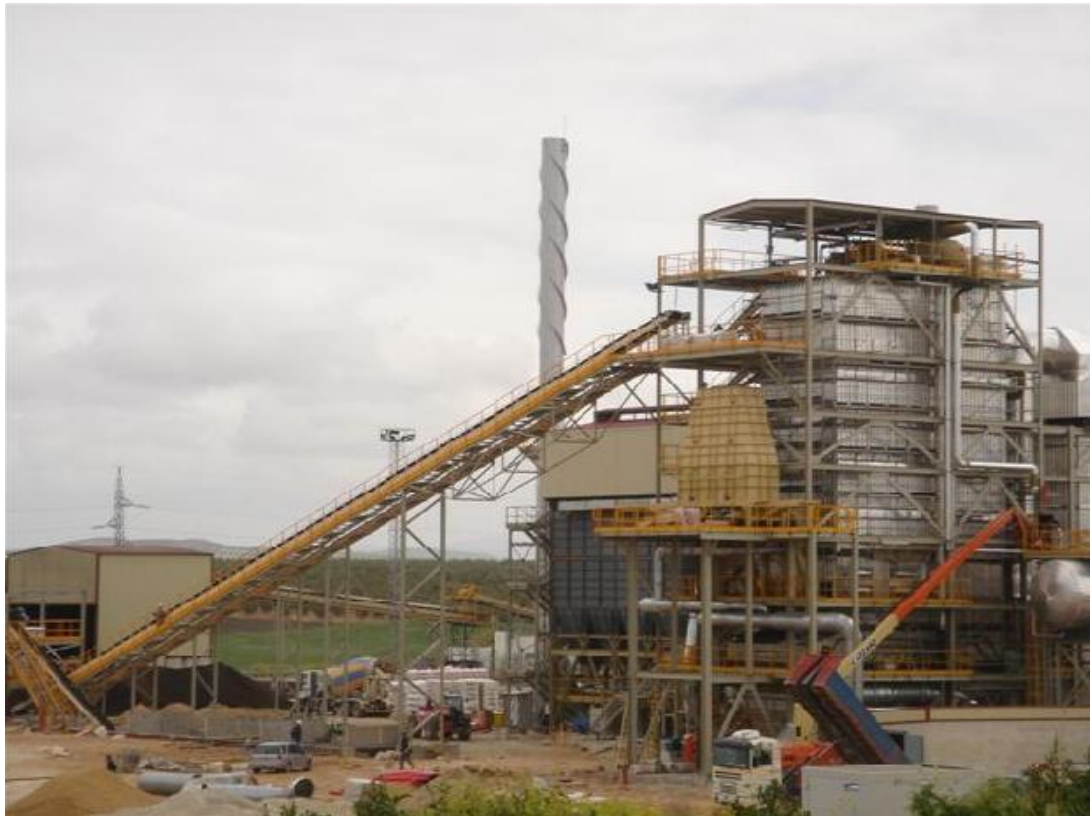
Figura 12. Sistema de cintas transportadoras de alimentación de caldera de combustión directa.
