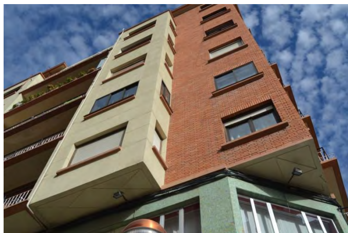
Lám. 350. Edificio de viviendas, c/ Beratúa 2, detalle de fachada, sofitos, Logroño, J. Carceller 1958
