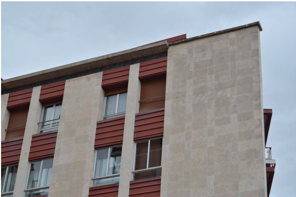
Lám. 430. Edificio de viviendas, pza/ Europa 7, detalle de fachada, Logroño, R. San Pedro 1961
