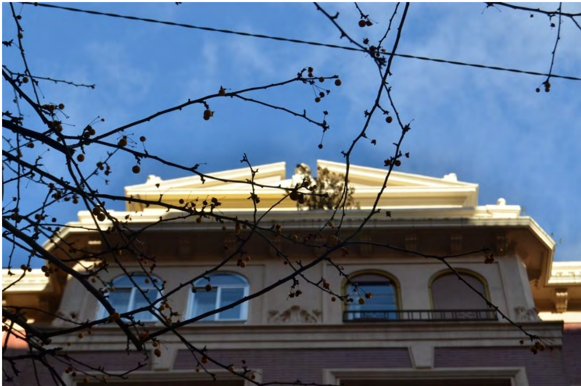
Lám. 87. Edificio de 12 viviendas y almacenes, c/ Doctores Castroviejo 1bis, detalle de fachada, coronación cuerpo central, Logroño, J. M a Carreras y R. Fontán 1947
