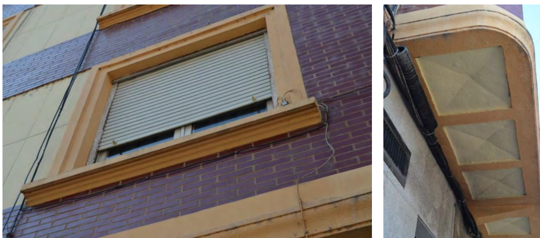
Lam. 297. Edificio de 14 viviendas, a/ de la Paz 70, detalles de fachada, Logroño, A. del Valle y F. del Valle 1957
