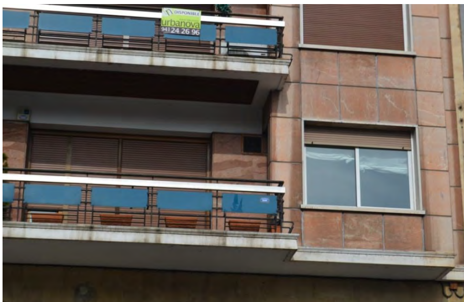
Lám. 413. Edificio de viviendas, c/ Muro de la Mata 6, detalle de fachada, Logroño, F. del Valle 1960
