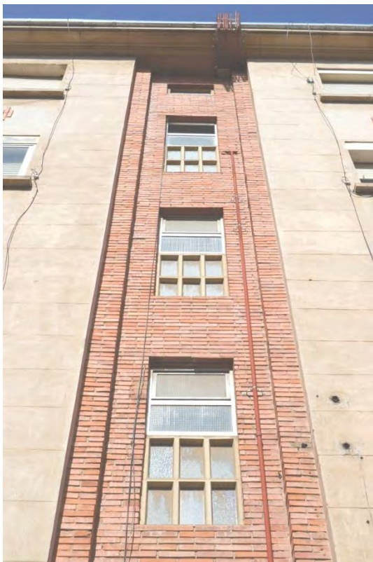
Lám. 375. Edificio de viviendas, calles Cantabria 27-31, Quintiliano 10-14 y Manzanera 12-16, detalle de fachada, Logroño, J. M a Carreras y R. Fontán 1958
