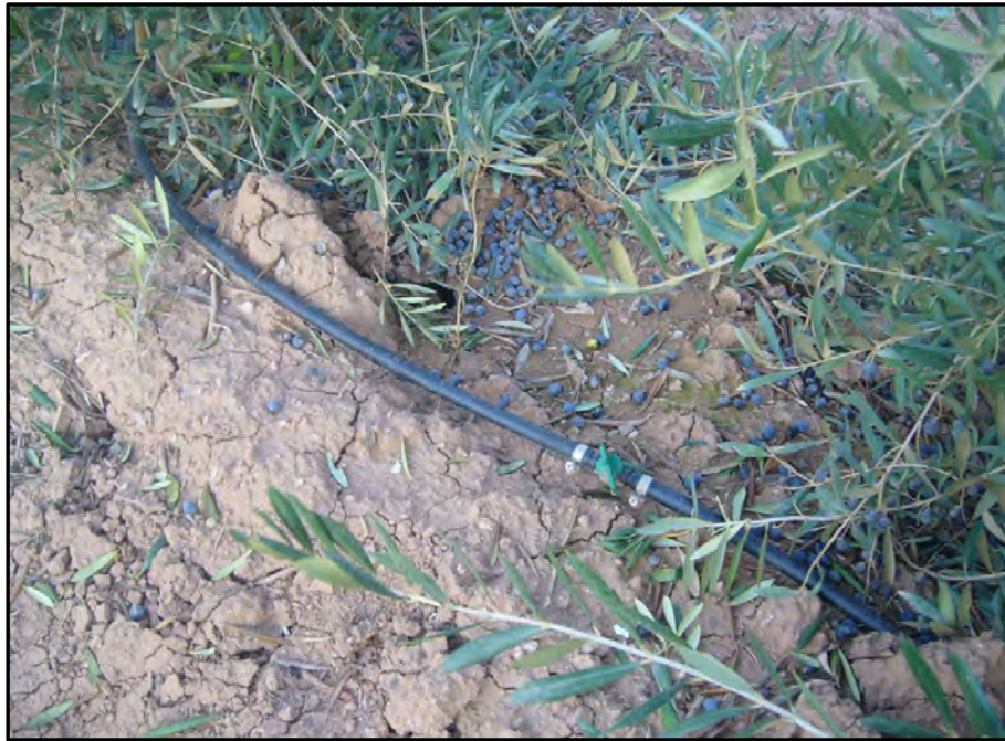
Fot. 12. Vista de la válvula que regula la aplicación de agua. En este caso corresponde a Riego Deficitario (RD)
